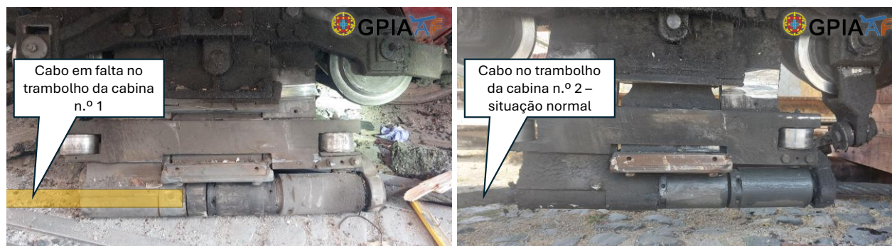
Fig. 4 - Situação do trambolho superior da cabina n.º 1, sem o cabo de ligação (imagem da esquerda), e o trambolho superior da cabina n.º 2 com o cabo fixado em situação normal (imagem da direita).
